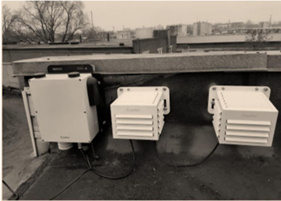
Рис. 1. Модули микростанции на крыше здания Регионального центра мониторинга
