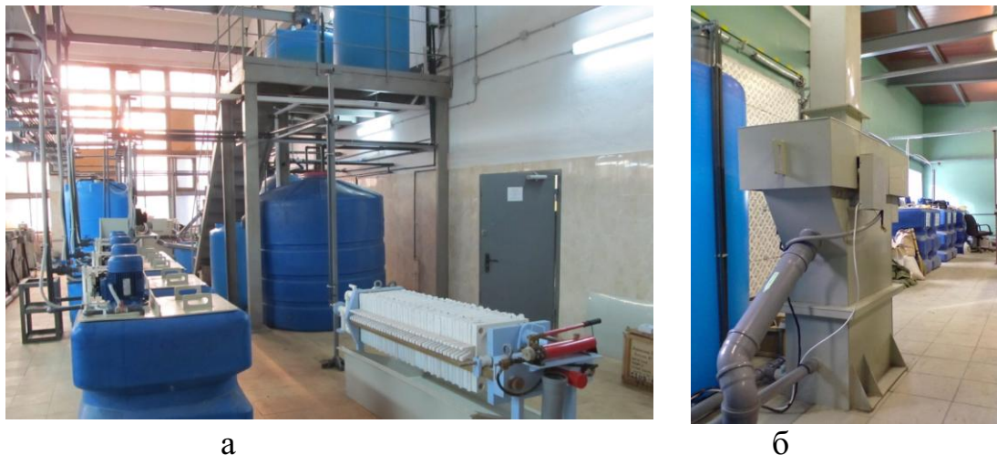
Рис. 1. Участок переработки кислотно-щелочных, хром и циан-содержащих сточных вод: а – общий вид; б – электрофлотатор (разработчик П. Н. Кисиленко)
